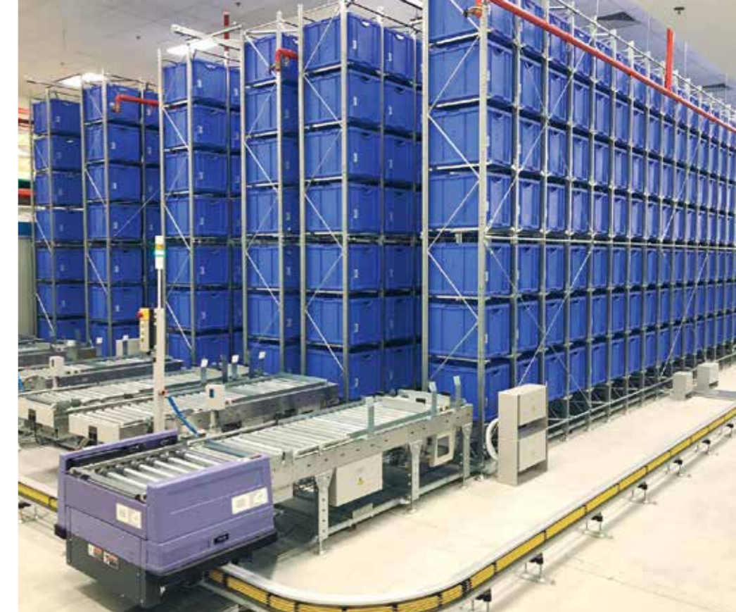
物品管理部の保管エリア。院内薬局と同様に高速搬送台車は、自動倉庫の側面から正面にかけたループ状の軌道を周回している。
