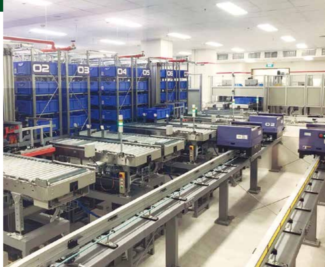
院内薬局の保管エリア。入出荷・ピッキングエリアから自動倉庫の入行っている。
