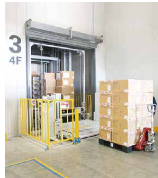
5階の在庫品を垂直搬送機で4階へ搬送。パレットに積載された段ボールは人手で下ろし、コンベヤに流していく。
