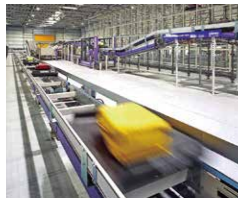
高速手荷物搬送システム。
