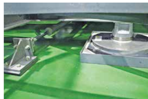
ラック下の免震装置。
