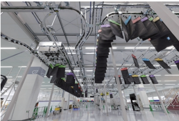
天井空間に設置したレール
