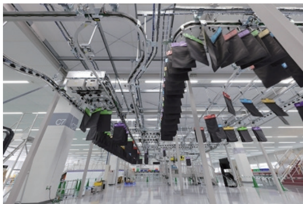
天井空間に設置したレール
