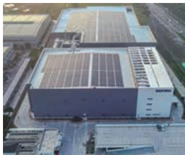
半導体・液晶生産ライン向けシステムの工場(中国・蘇州)の屋根に設置した太陽光発電システム
