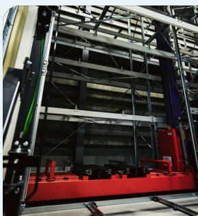
長尺品にも対応可能な自動倉庫
