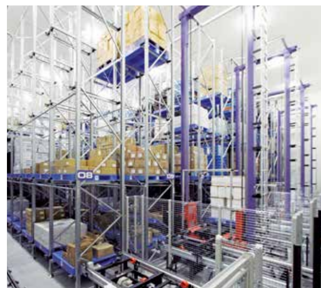
パレット自動倉庫「コンパクトシステム」は、高さを4段に抑え、奥行きは約80mという広い土地を活用したレイアウト。
