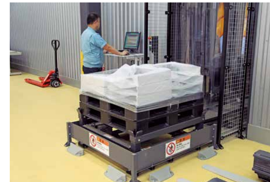
パレット自動倉庫「コンパクトシステム」のラック側面の出庫口。スタッカークレーン1基、格納数236パレット。
