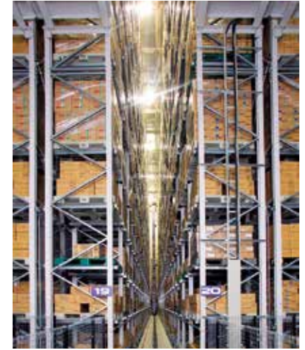
自動倉庫のラック上部に制振ダンパーを設置し地震発生時のラックの揺れを軽減している。
