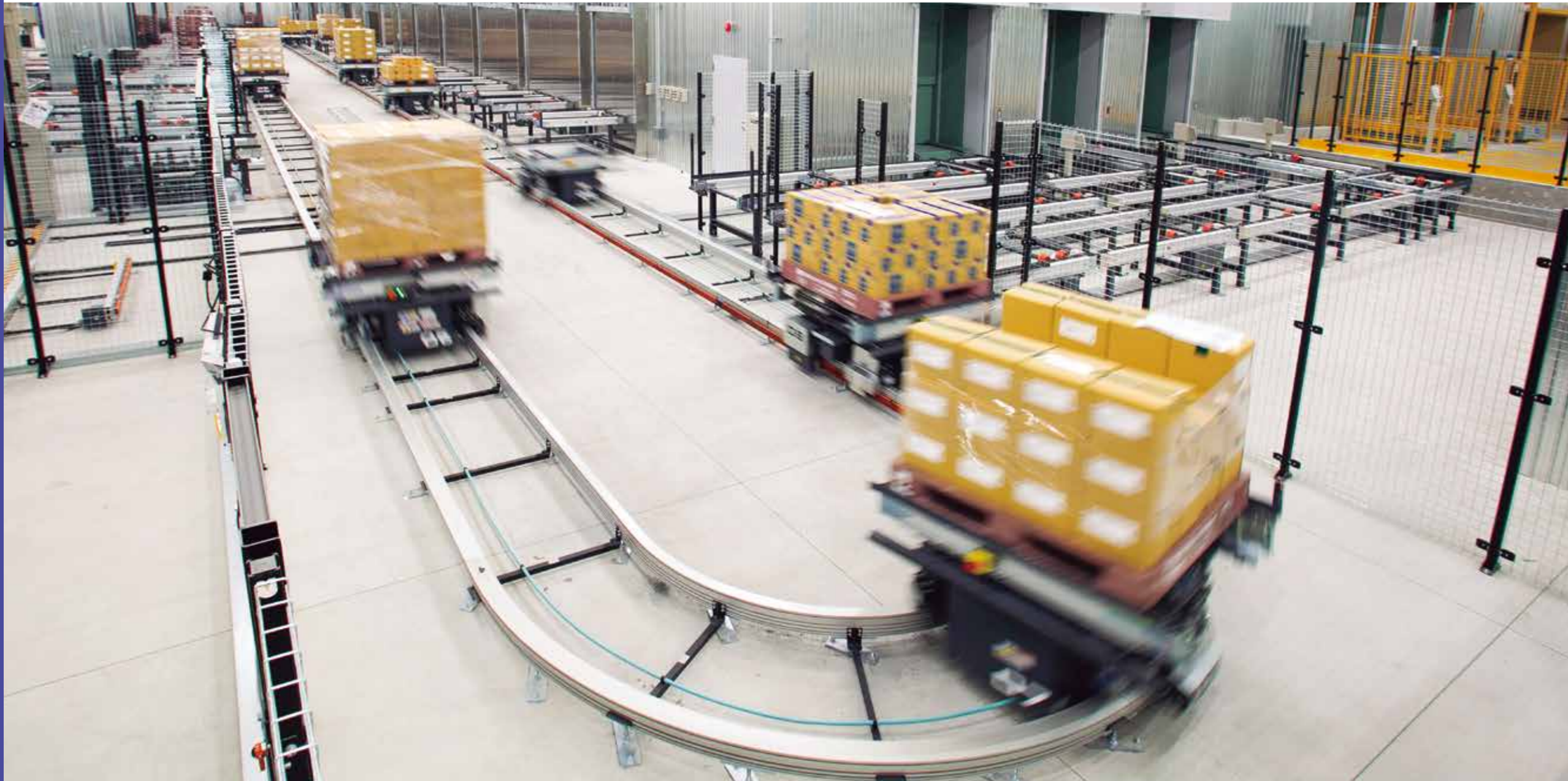
冷凍および冷蔵のパレット自動倉庫～ピッキングステーション～垂直搬送機への受け渡しをループ式の高速搬送台車で自動化している。
