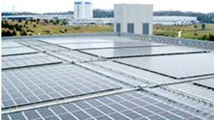
屋上に設置したソーラーモジュール
