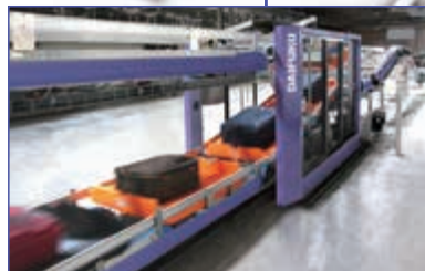
手荷物搬送・仕分けシステム
