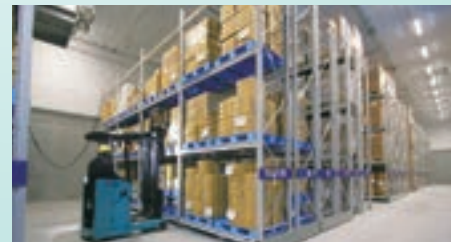
流通加工センターの冷凍庫(-25℃)に設置
