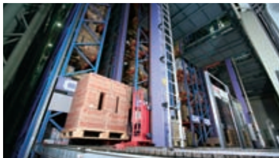
約4,000パレット格納の自動倉庫。四川大地震発生から30分後には正常稼働、地震にも強いことが証明された
