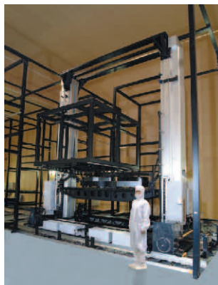
1 液晶工場向け保管システム
