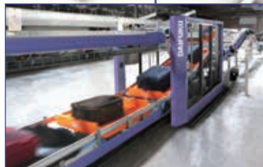
手荷物搬送・仕分けシステム
