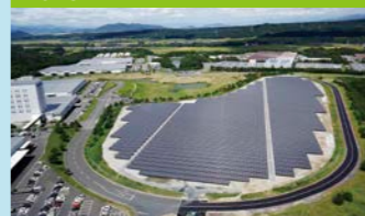
ダイフク滋賀メガソーラー 発電容量は4,438kW、年間発電量は430万kWh
