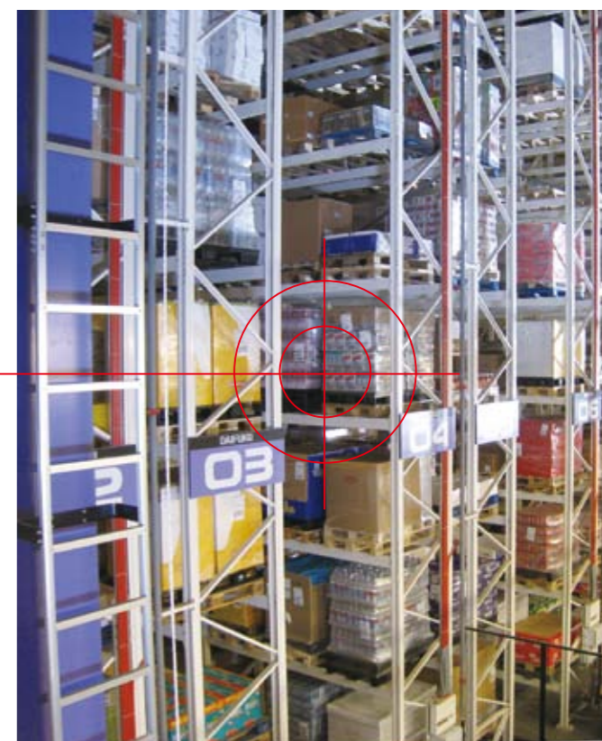
スタックークレーン13基、2万6,000パレット格納の自動倉庫
