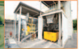
⑦ 防油フェンス
