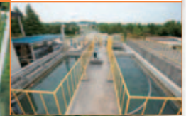
⑥ 汚泥再資源化施設
