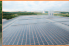
④ 太陽光発電システム
