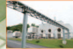
⑤ コージェネレーションシステム
