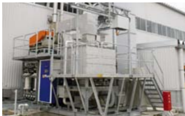
滋賀事業所に設置しているVOC除去装置
