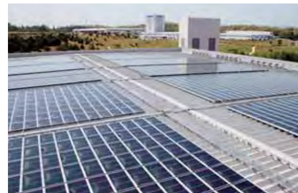
およそ幅60m×奥行き70mの屋上に設置したソーラーモジュール
