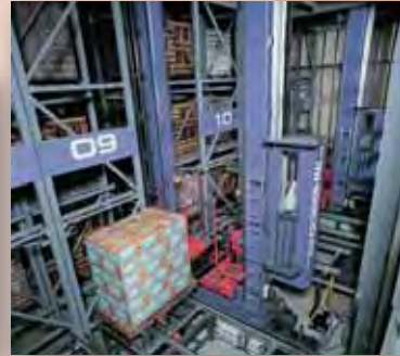
飲料：パレット自動倉庫
