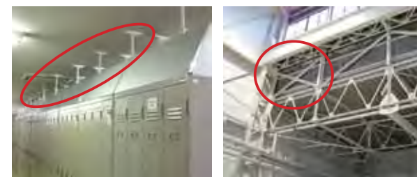
事務所のロッカー転倒防止
