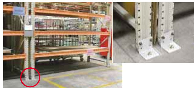
アンカーボルトで転倒防止
