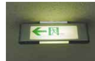
非常灯など常時使用するものはLEDタイプに変更
