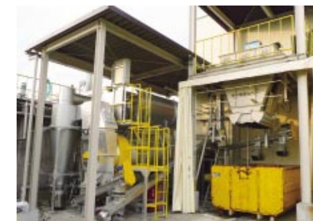
汚泥の再資源化施設
