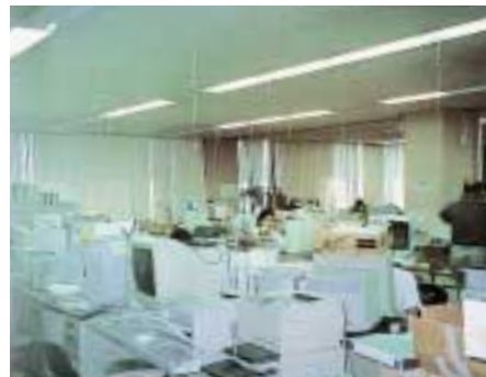
照明の省エネルギー 紐スイッチで、必要に応じて点灯
